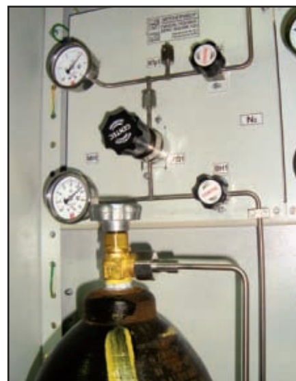
Рис.4. Вид газовой панели
