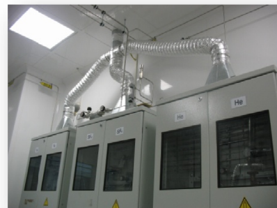
Рис. Ряд шкафов с вытяжной вентиляцией
