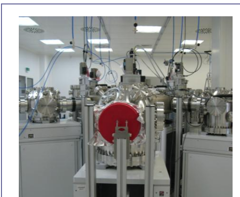
Фото 6: Газовая (трубопроводная) обвязка технологического оборудования
