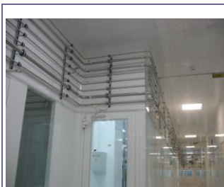
Фото 2: Смонтированные газовые магистрали в составе системы технологического газоснабжения цеха
