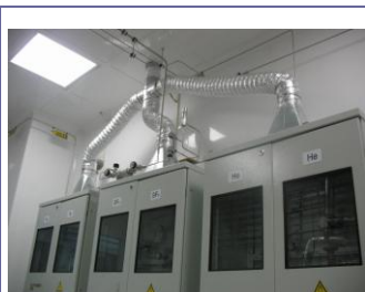
Фото 3: Газобаллонные шкафы и разводка трубопроводов системы технологического газоснабжения цеха
